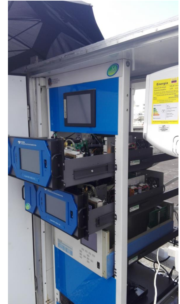
Cabina de analizadores automáticos de gases, estación Gobernación
