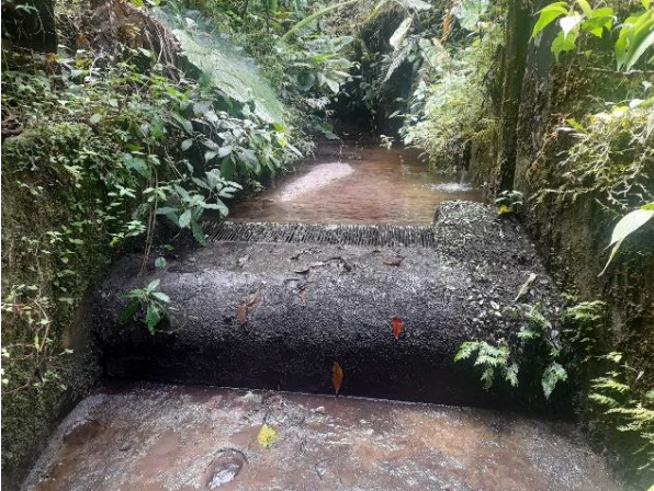
Imagen No 7 Captación 2 Abasto Muelas...
