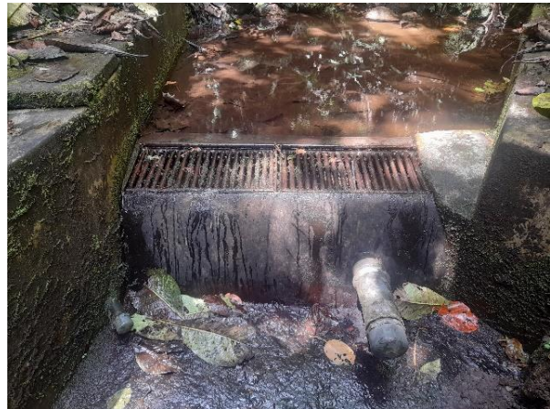
Imagen No 8 Captación 3 Abasto Muelas...
