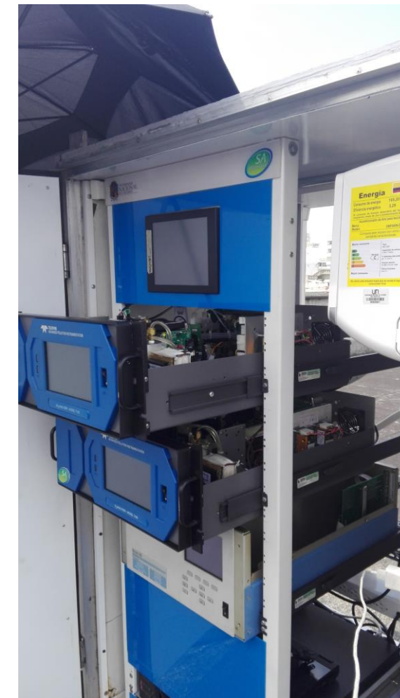
Cabina de analizadores automáticos de gases, estación Gobernación
