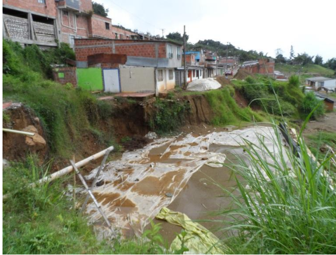
Figura 23.5. Deslizamiento del sector del barrio La Marina II, asociado a intervenciones por ejecución de llenos y fugas de red de alcantarillado. Hacia la base pantalla anclada construida, y donde se requiere reconfiguración de la ladera
