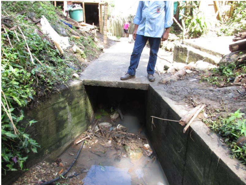
Figura 3. Sección hidráulica de canalización entre barrios Víctor Renán Barco y Popular. Ver detalle de mantenimiento y estado
