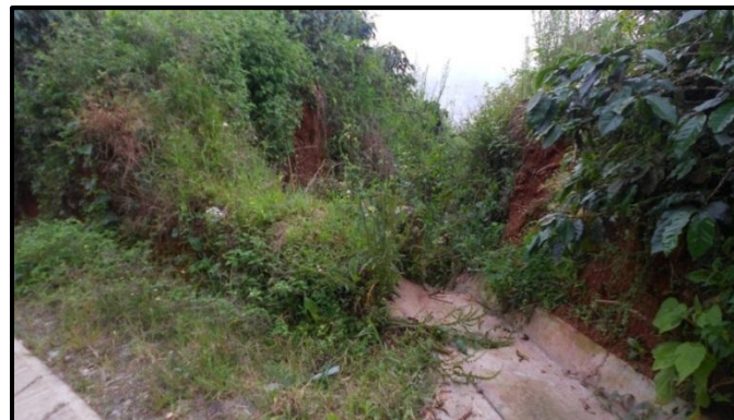
Figura. 9.17. Entrega no controlada sobre la vía principal del sector El Madroño, a unos 50 metros antes de la Subestación de Policía. Proceso de erosión concentrada.
