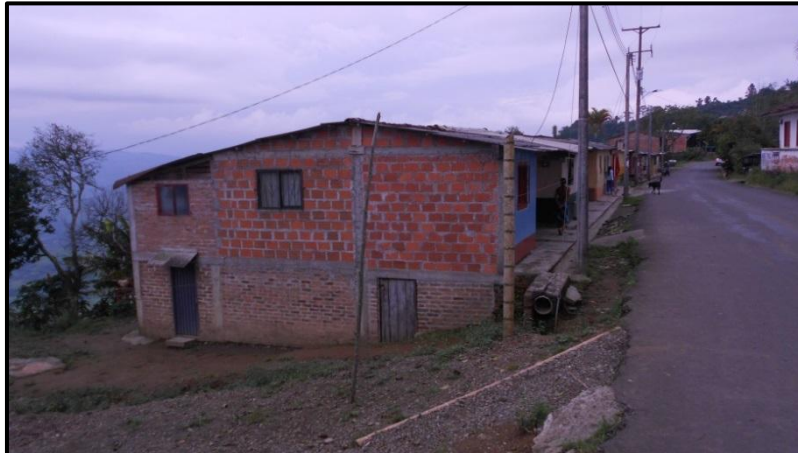
Figura 9.4 Deficiencias de manejo de aguas de la vía y parte posterior de viviendas del barrio Villa Tulia, supedita a cambio der condiciones actuales
