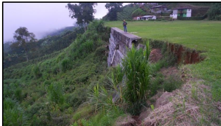
Figura 9.5 Conformación de llenos para desarrollo de cancha en el sector de La Pista. Muro propenso al colapso por volteo.
