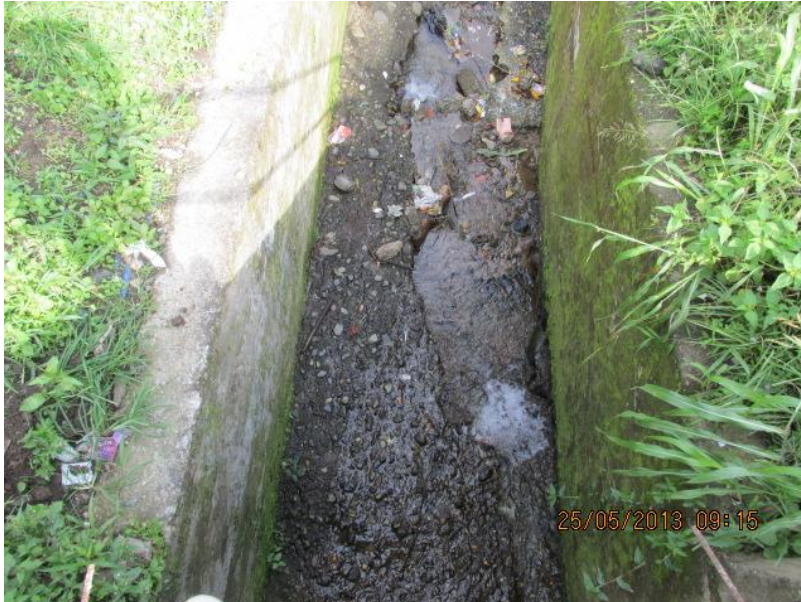
Figura 24.10. Detalle del grado de deterioro de algunos tramos de la sección canalizada de la Quebrada Cameguadua
