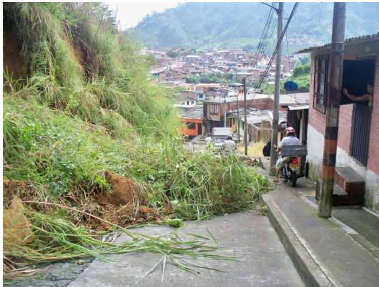
Figura 24.8. Deslizamiento reciente en el barrio Los Mangos. Proceso de remoción en masa de baja magnitud que obstruyó vía de acceso
