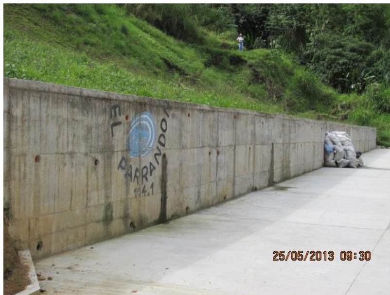
Figura 24.7. Muro de contención construido como medida correctiva y de mitigación de amenaza por procesos de remoción en masa, en el barrio María Auxiliadora
