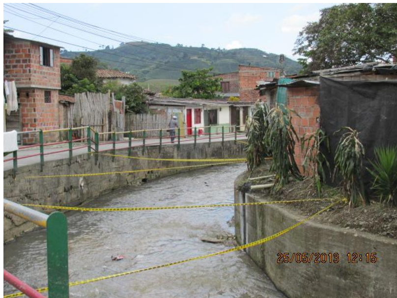
Figura 24.2. Sección canalizada de la Quebrada Cameguadua. Obsérvese la reducción de la sección hidráulica producto del urbanismo en las riberas.
