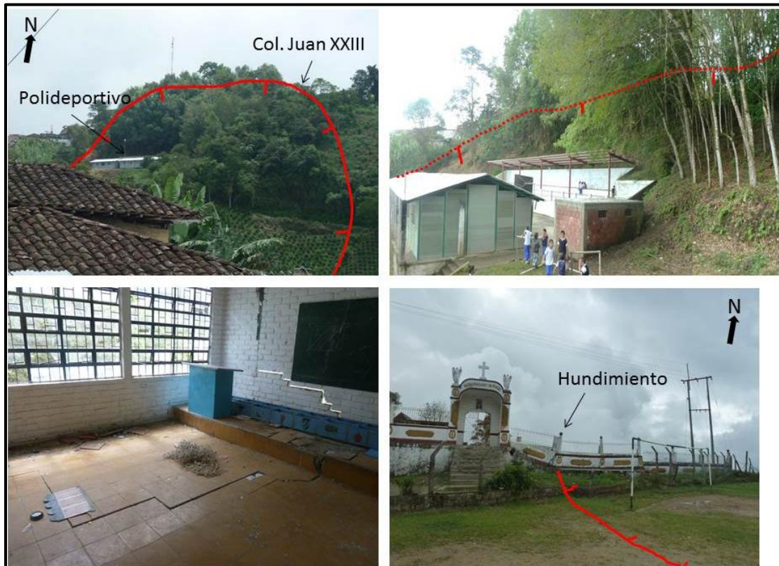
Figura 5.7. Diferentes aspectos del Sitio Crítico SAM-1 en el cual se observa la infraestructura afectada y evidencias de actividad como reptación de árboles en el coluvión (superior der.) y grietas y hundimientos en la corona (fotos inferiores).
