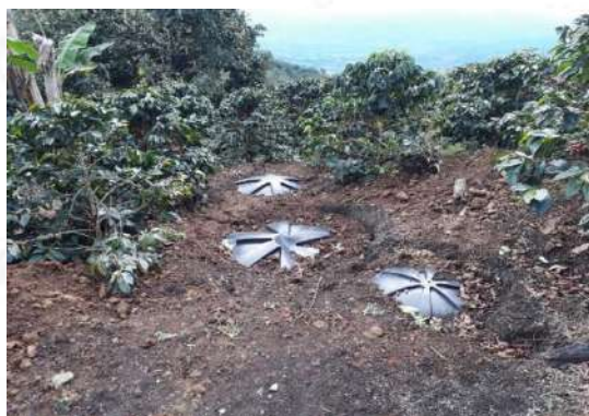
Gloria Isabel Aricapa Blandón. Sistema Séptico instalado. Risaralda, vereda Quebra de Varillas
