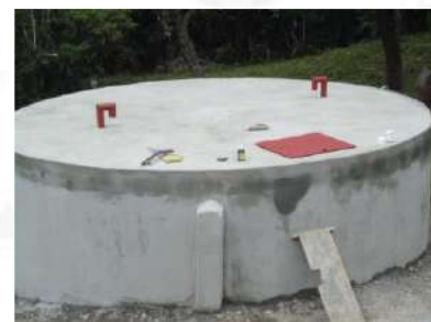
Tapa para tanque de almacenamiento Vereda La Palma - Samaná
