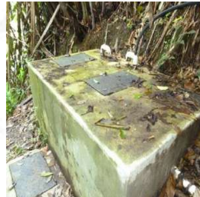
Tanque de almacenamiento de agua; Microcuenca Buenos Aires. Municipio de Riosucio
