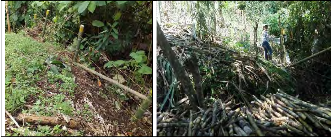
Instalación de cerca inerte en el municipio de Belalcázar. Autor: Sonia Cortés Bedoya
