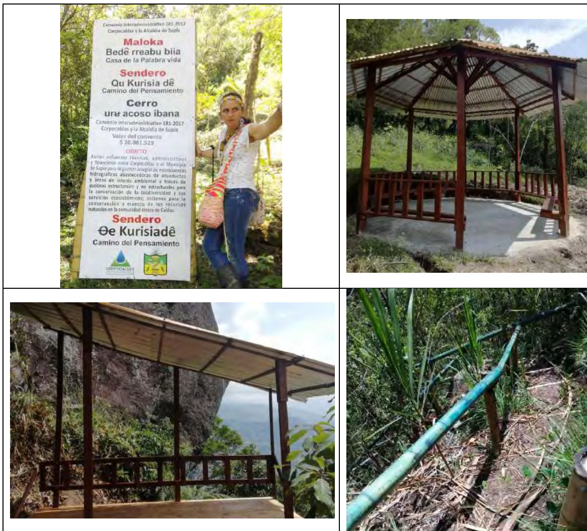
Construcción de pasamanos, maloka, mirador en la comunidad indígena La Trina, predio el Cerro, municipio de Supía. Autor: Sonia Cortés Bedoya.
