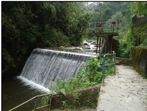
Figura 9. Captación Río Chinchiná, cerca de la Planta Luis Prieto. Fuente: Propia.
