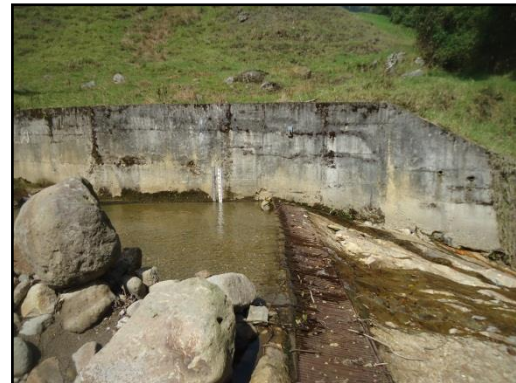
Figura 10. Captación de las Quebradas La María y California. Fuente: Propia.
