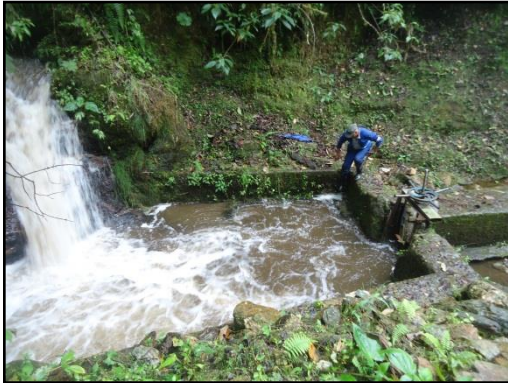
Figura 3. Captación Quebrada La Arenosa. Fuente: Propia.
