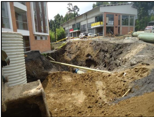
Figura 73. Cambio de Tubería por ruptura, localizado en Hotel Ares localizado en la vía que lleva del Barrio La Enea al SENA, donde anteriormente no existía la edificación y se realizó un importante movimiento de tierra.
