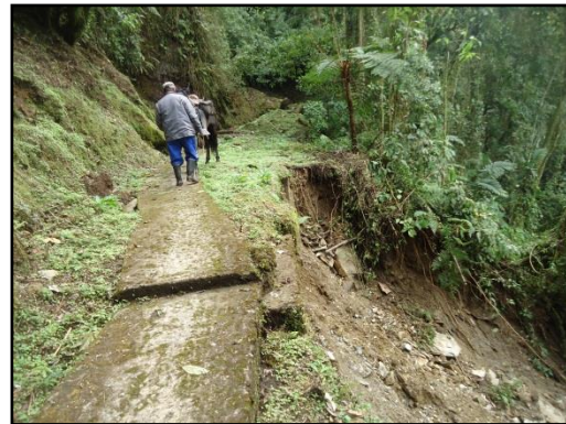
Figura 74. Deslizamiento el cual afecto la base del talud generado por infiltración generado por el canal de aducción de aguas de Manizales. Ubicada en el área de influencia de la Quebrada La Guerra. Fuente: Propia.
