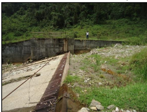
Figura 11. Captación de la Quebrada Romerales. Fuente: Propia.
