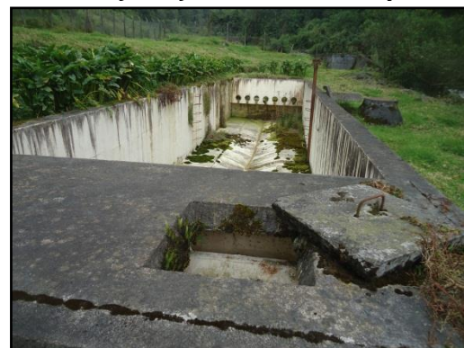
Figura 12. Captación de la Quebrada Termales. Fuente: Propia.
