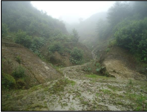
Figura 67. Movimiento en masa observado en la parte alta de la Quebrada La Arenosa, el cual presenta obra de estabilización. Fuente: Propia.
