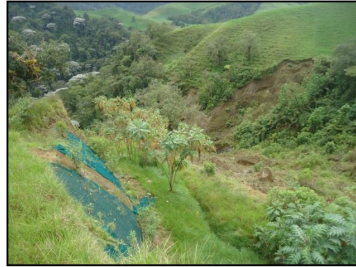
Figura 68. Movimiento en masa observado en la ladera SE de la Quebrada Olivares, Vereda Buenavista, sector Las margaritas, presenta obra de estabilización. Fuente: Propia.
