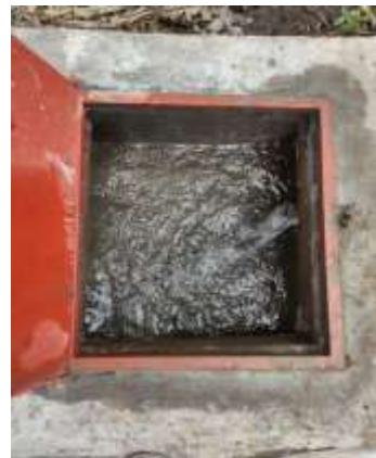
Cámara de salida
