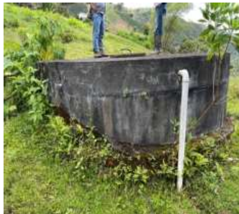
Tanque de almacenamiento existente
