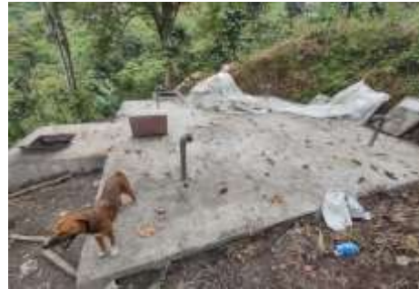
Tanque de almacenamiento después
