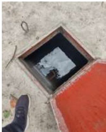
Tanque de almacenamiento lleno
