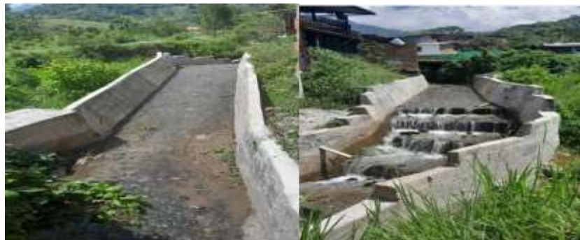
Canalización quebrada Honduras, centro poblado Territorio Ancestral San Lorenzo, Riosucio.
