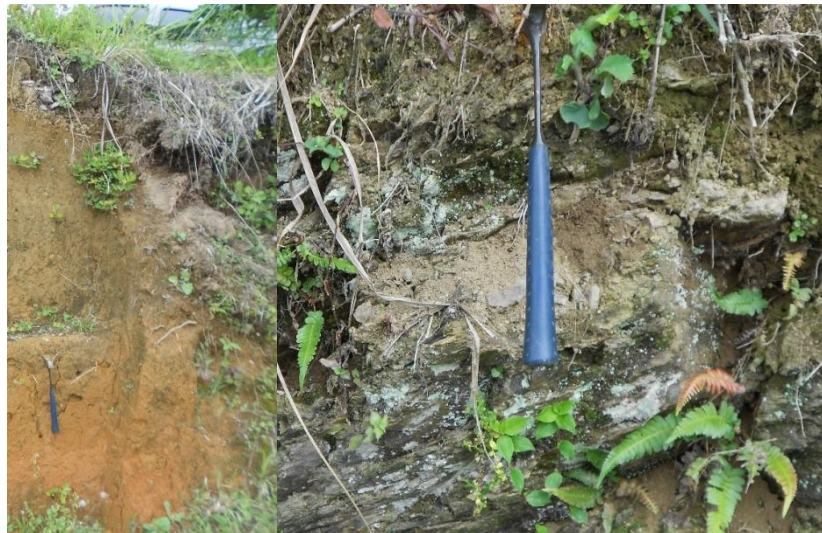
Figura 27.48. Nivel I de meteorización del basamento en el sector de la Estación de Policía de La Cabaña (Izq.) Nivel II de meteorización en el talud de la carretera en la salida hacia Manizales (Der).
