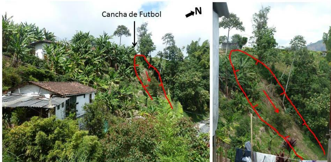
Figura 27.14. Flujo de suelo entre la cancha y la vía Manizales-La Siria en el Sitio Crítico BT-3 en el Bajo Tablazo (Manizales).
