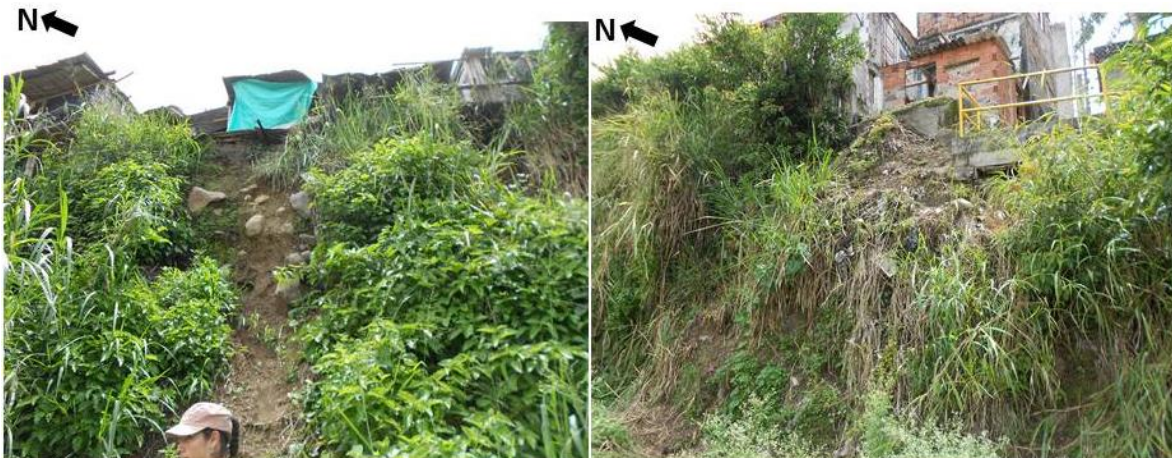
Figura 27.20. Caída de bloques desprendidos de los depósitos de flujos de escombros del Kilómetro 41 y mal manejo de aguas superficiales y escombros a lo largo del talud oriental de la carrilera.
