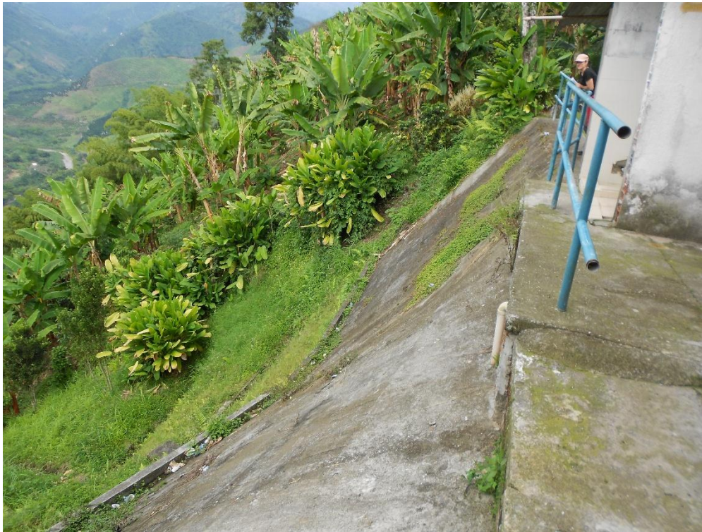
Figura 27.50. Pantalla anclada sin mantenimiento, en la ladera norte de La Cabaña, diagonal a la Iglesia.
