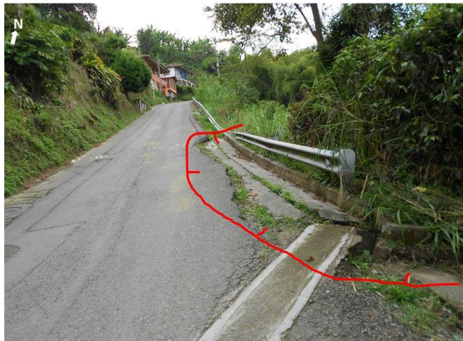
Figura 27.29. Detalle del Sitio Crítico SP-1 en el cual se presenta desconfinamiento de la vía por mal manejo de aguas de escorrentía.
