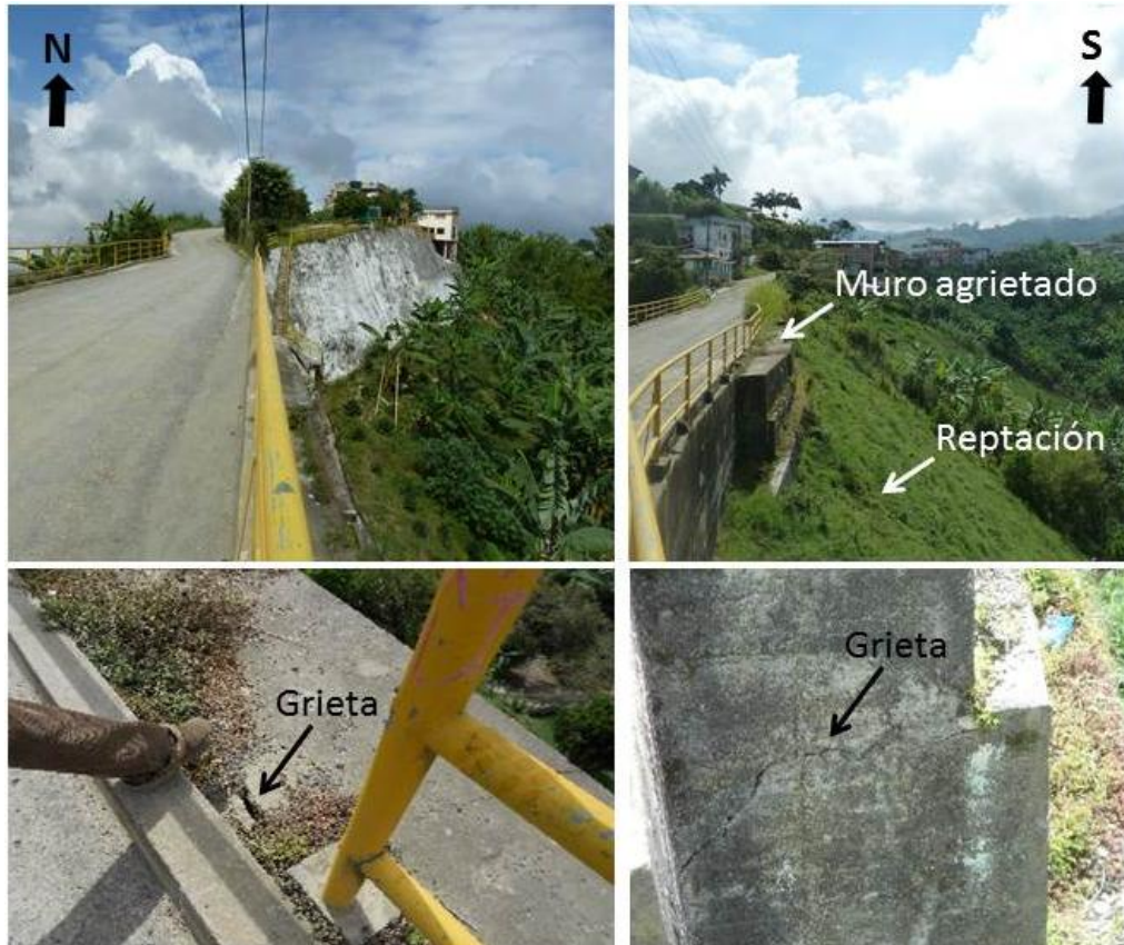
Figura 27.43. Muros en gaviones revestidos y champiao (revocados) en el talud Noreste de la carretera hacia El Guineo (arriba Izq.). En las fotografías restantes se muestran fracturas y agrietamientos sobre las obras en el talud suroeste de la carretera a El Guineo.
