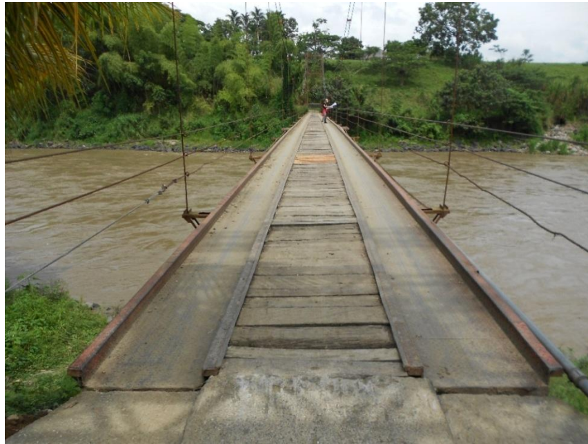
Figura 27.22. Puente colgante sobre el Río Cauca en el corregimiento Kilómetro 41, similar al que fue destruido por el lahar originado el 13.11.1985 durante la erupción del Volcán Nevado del Ruiz
