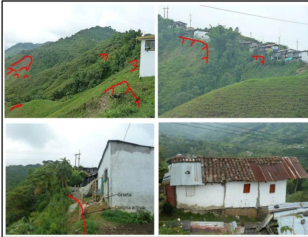
Figura 7.6. Procesos erosivos en la ladera norte del Barrio Medellín y Vivienda con fracturas (Inferior Derecha).
