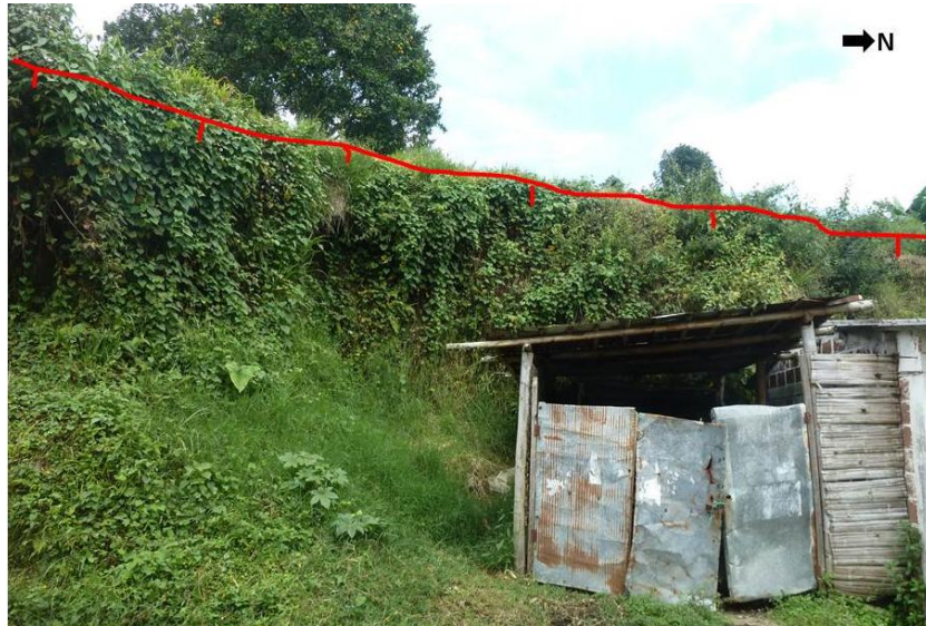
Figura 18.5. Sitio Crítico CAS-2 en el cual se observa la sobre-excavación en el talud para construir una bodega-garaje (Fecha fotos: 22.05.2013).
