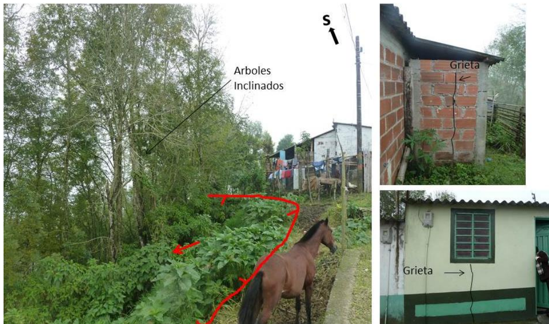
Figura 18.13. Sitio Crítico SB-3. Proceso erosivo en el Barrio Pueblo Nuevo (Fecha fotos: 22.05.2013)
