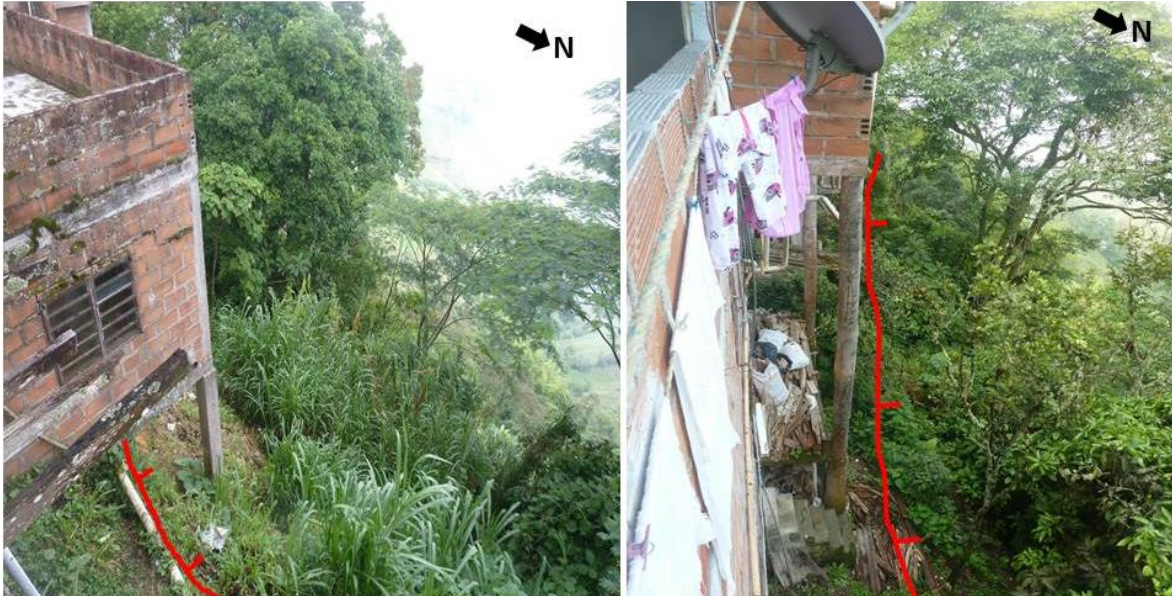
Figura 18.11. Diferentes aspectos del Sitio Critico SB-1en el cual se observa la inclinación y estado del escarpe en la ladera Occidental y los inadecuados sistemas constructivos de las viviendas (Fecha fotos: 22.05.2013).
