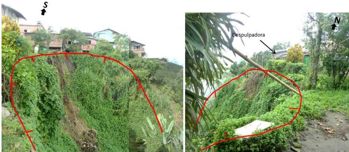
Figura 18.4. Diferentes aspectos del Sitio Crítico CAS-1 en el cual se observa la altura y estado del escarpe (izq.) y la presencia de descoles sobre la cara libre del talud (der.) (Fecha fotos: 22.05.2013)
