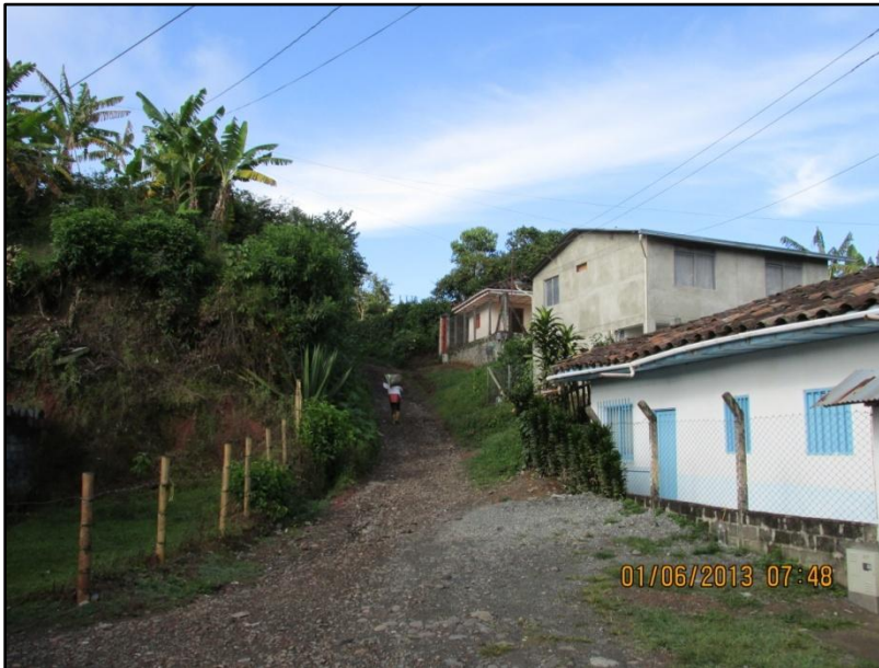
Figura 21.25. Detalle de presencia de taludes subverticales (Formación Amagá) y deficiencia de obras complementarias para el manejo y control de las aguas de escorrentía en la infraestructura vial
