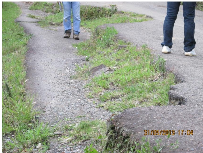
Figura21.9. Afectación vial por asentamiento del terreno.
