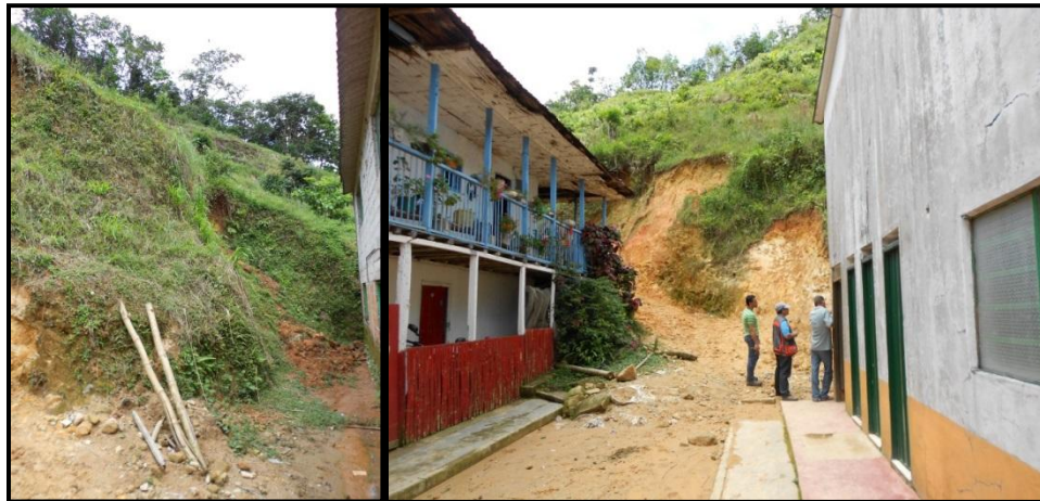
Figura 1.28. Deslizamientos presentes hacia el sector SE del caserío, en la parte trasera de la escuela.
