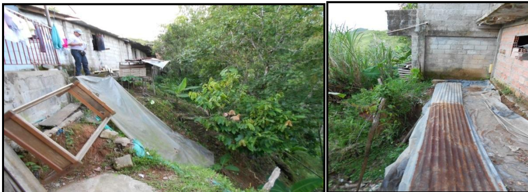
Figura 1.21. Pequeños deslizamientos detrás de las casas a causas del mal vertimiento de las aguas.
