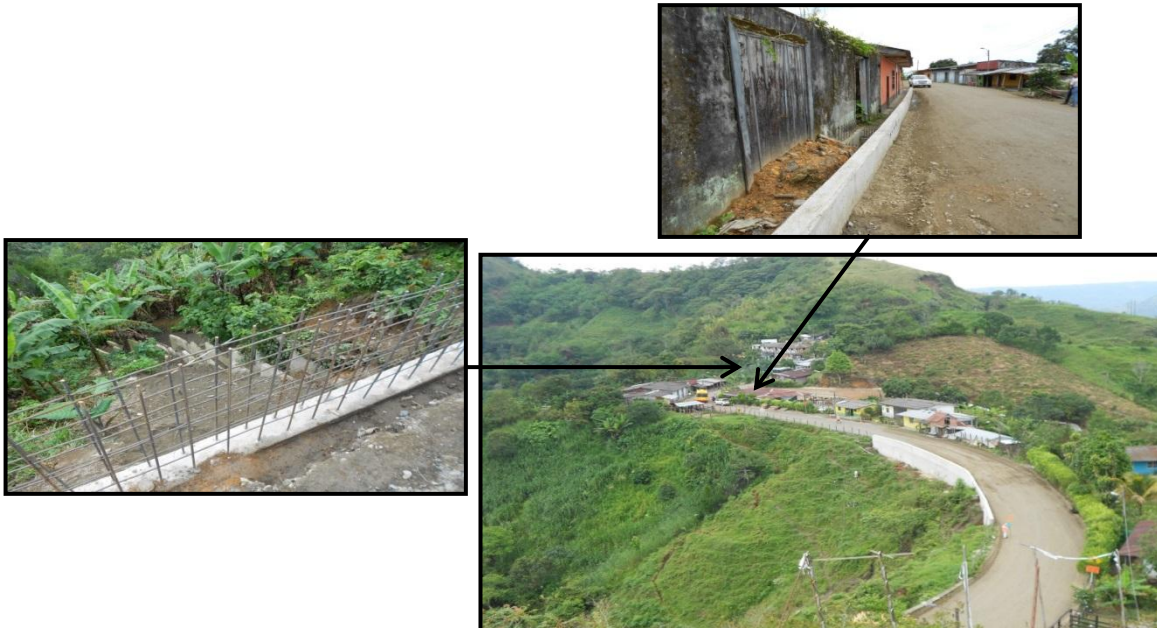
Figura 1.24. Obras de mitigación del riesgo por deslizamientos que afectan al caserío Rancholargo y principalmente a la vía Puente La Miel-Samaná. En la foto inferior derecha, en primer plano el muro sobre la parte N de la carretera y dos fotos mostrando detalles de las obras en la parte media del caserío, foto de la izquierda, muro de protección y obras complementarias y foto superior derecha muro en la parte sur de la carretera.
