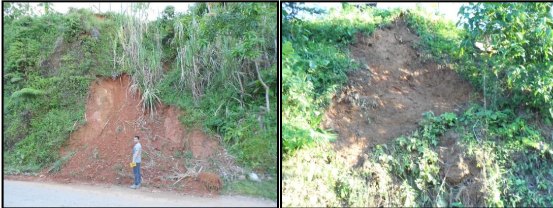
Figura 1.19. Fotografía izquierda, salida hacia Norcasia se observa un deslizamiento superficial, Fotografía derecha, salido hacia Florencia otro deslizamiento, en las dos imágenes anteriores se aprecia una susceptibilidad alta por deslizamientos.
