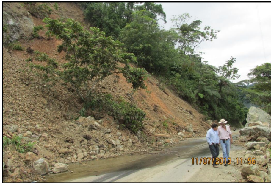
Figura 11.3. Caída de rocas y material residual, producto de las precipitaciones y grado de meteorización física y fracturamiento del macizo rocoso.
