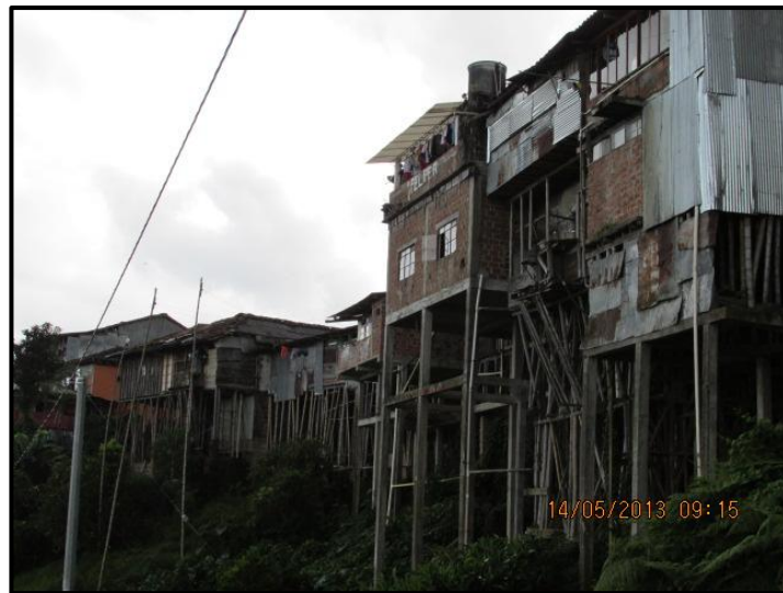
Figura 11.1 Punto crítico municipio de San José, en el acceso sur de la cabecera municipal. Viviendas en sector de alta pendiente y con vulnerabilidad alta
