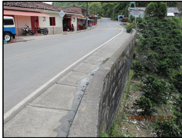
Figura 11.6. Construcción de muro en concreto reforzado para recuperar y garantizar estabilidad de banca
