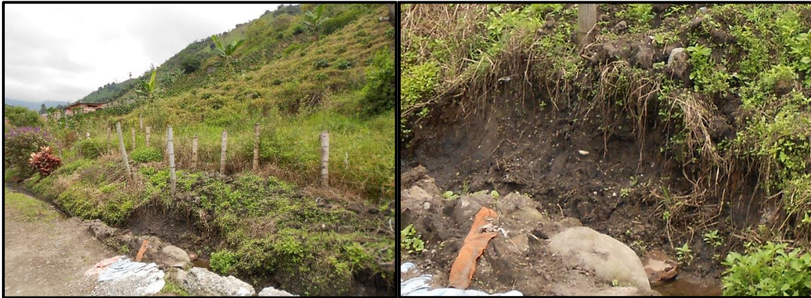
Figura 20.7. Izquierda: Límite urbano sur-occidental del caserío Nueva Primavera donde se localizan los depósitos coluviales sobre la mayor pendiente. Derecha: Detalle del depósito coluvial.
